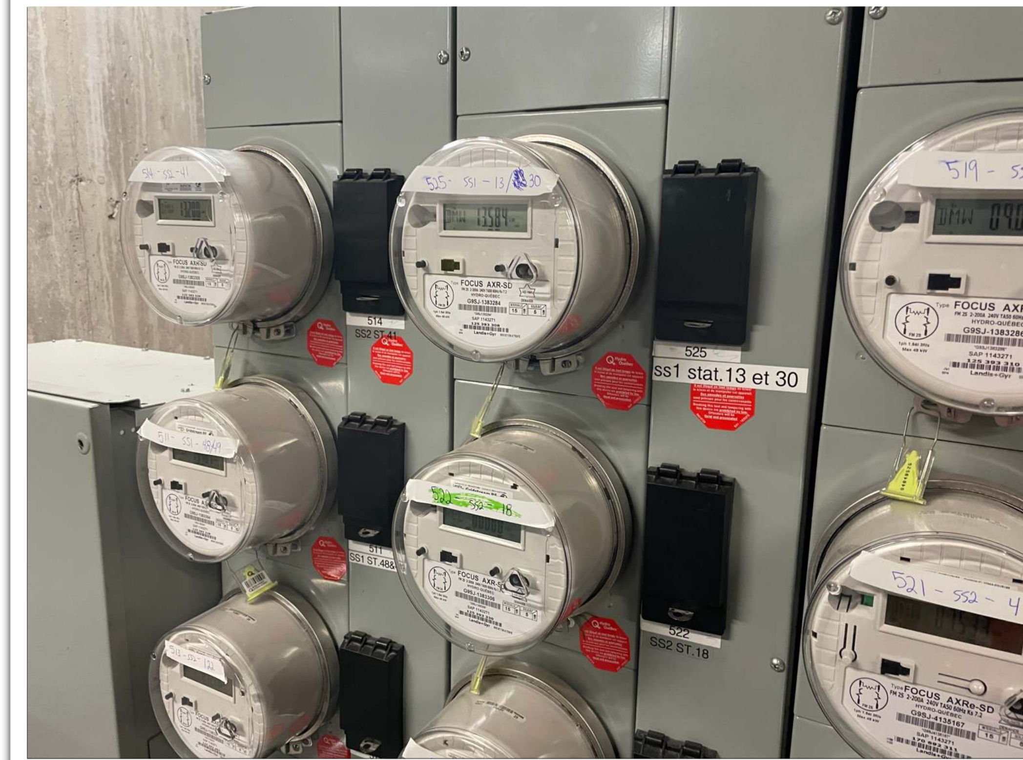
Vérification des compteurs et stationnements
