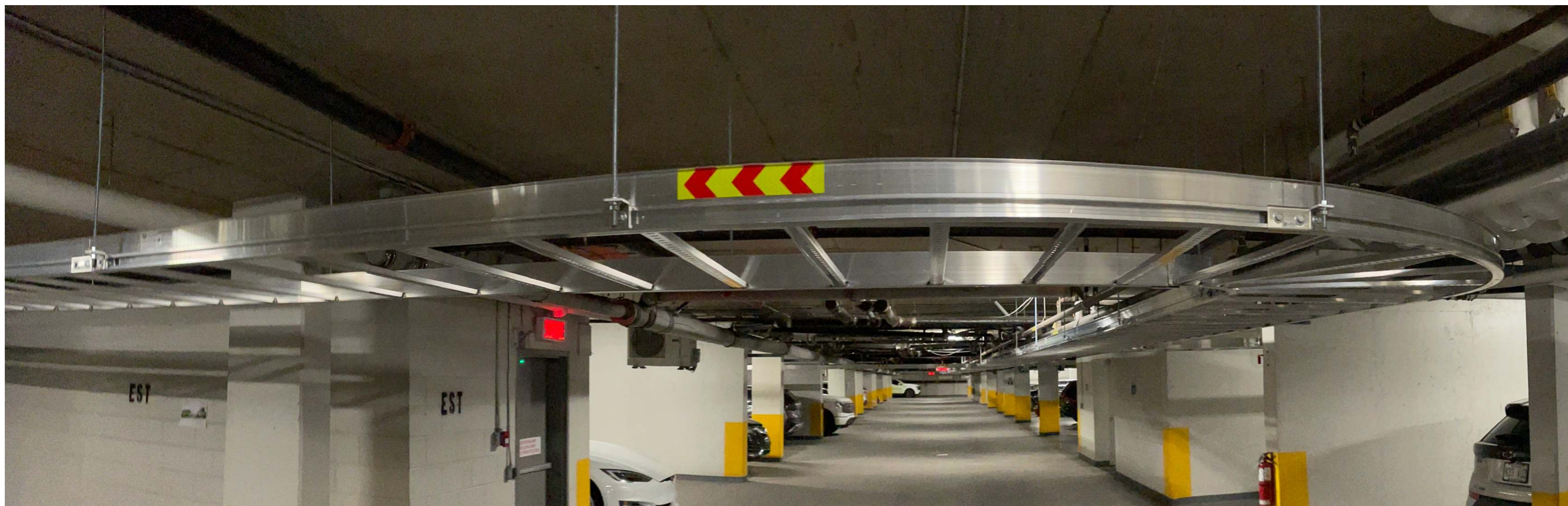
Vue panoramique du chemin de câbles SS1
