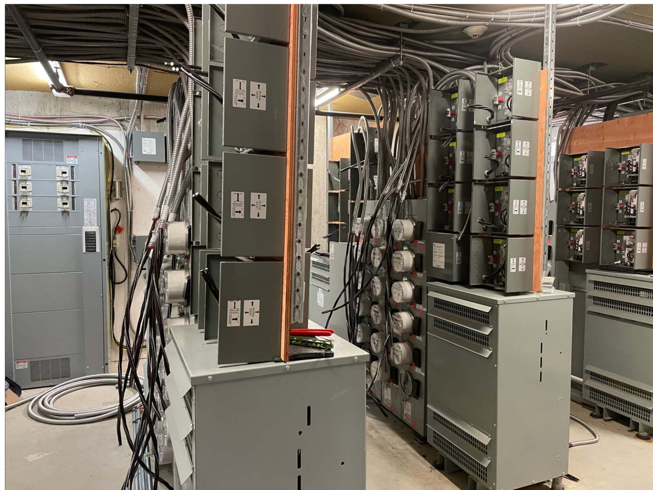
Branchement des DCC aux compteurs Tour Est
